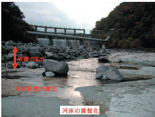
写真1 川底の露盤化
